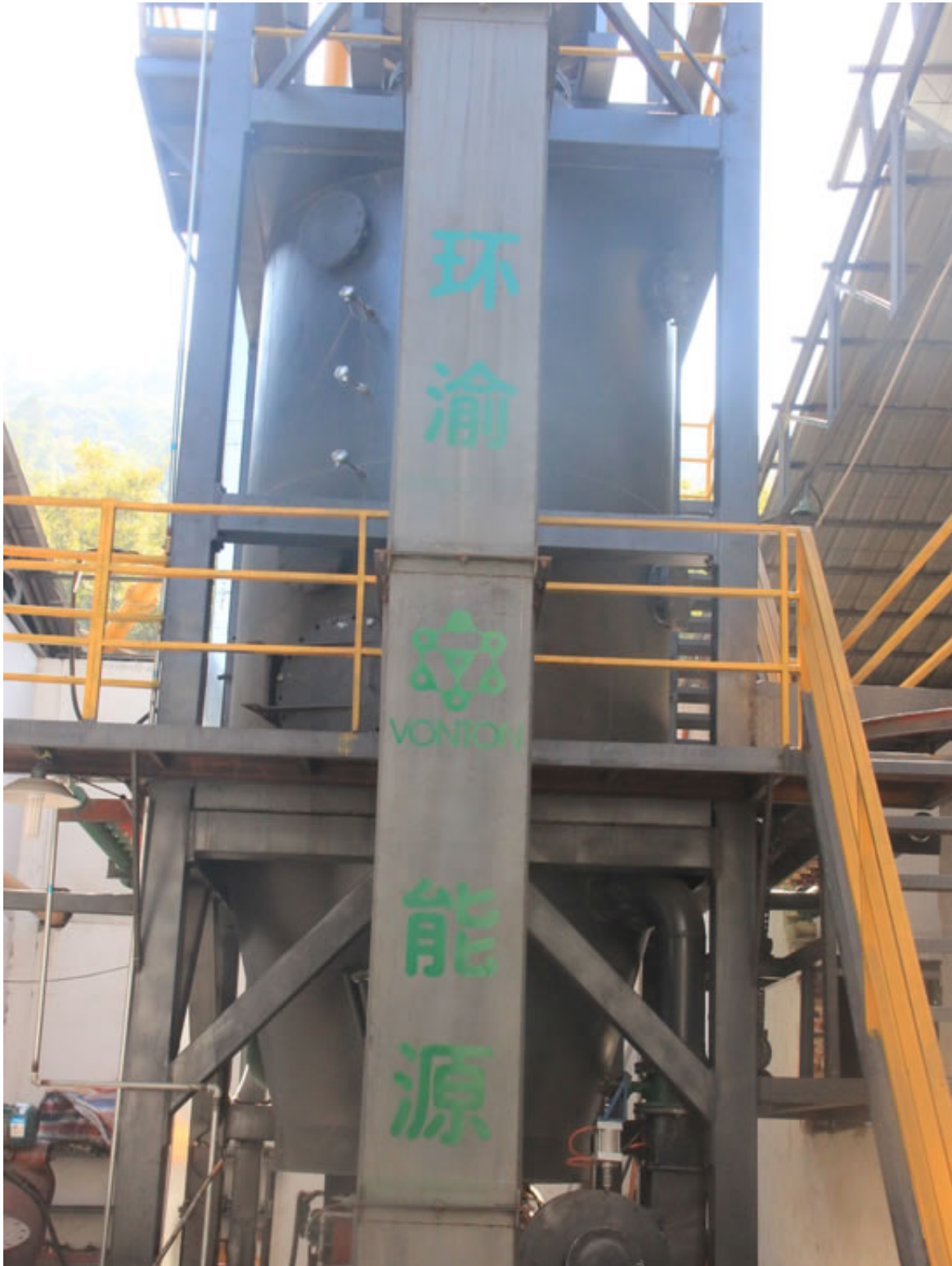
2、6吨气化炉，应用于6吨蒸汽锅炉
