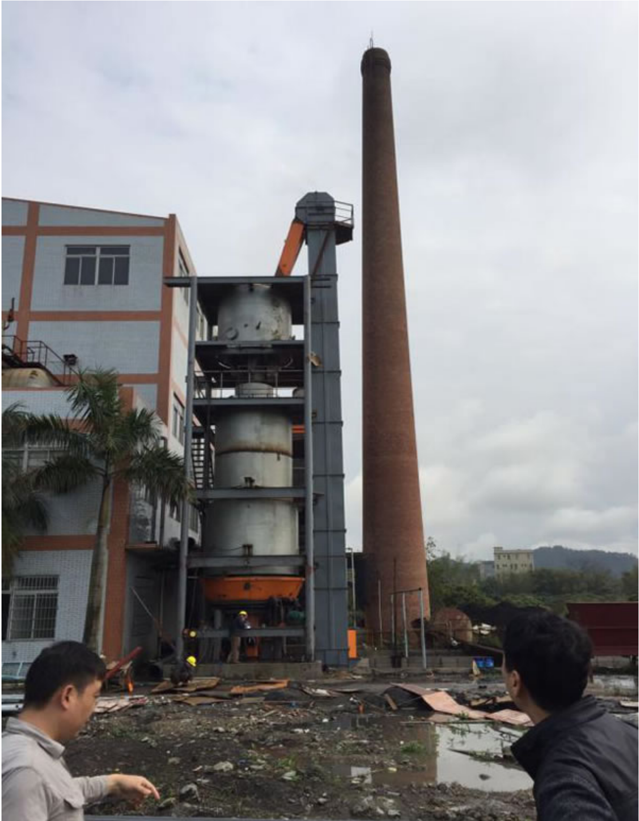
5、10吨气化炉，应用于10吨导热油锅炉
