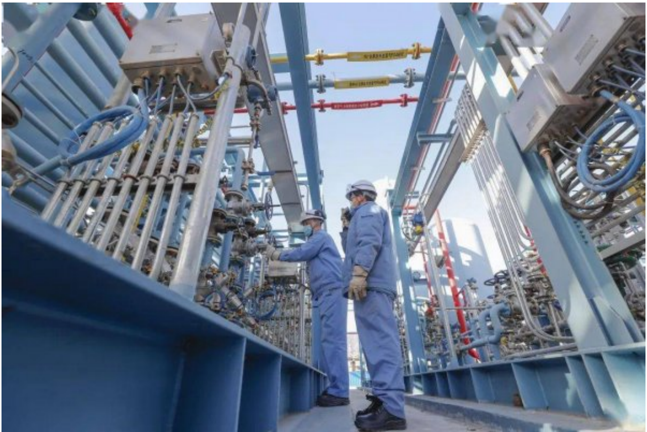
氢气新能源装置人员现场确认工艺参数。
