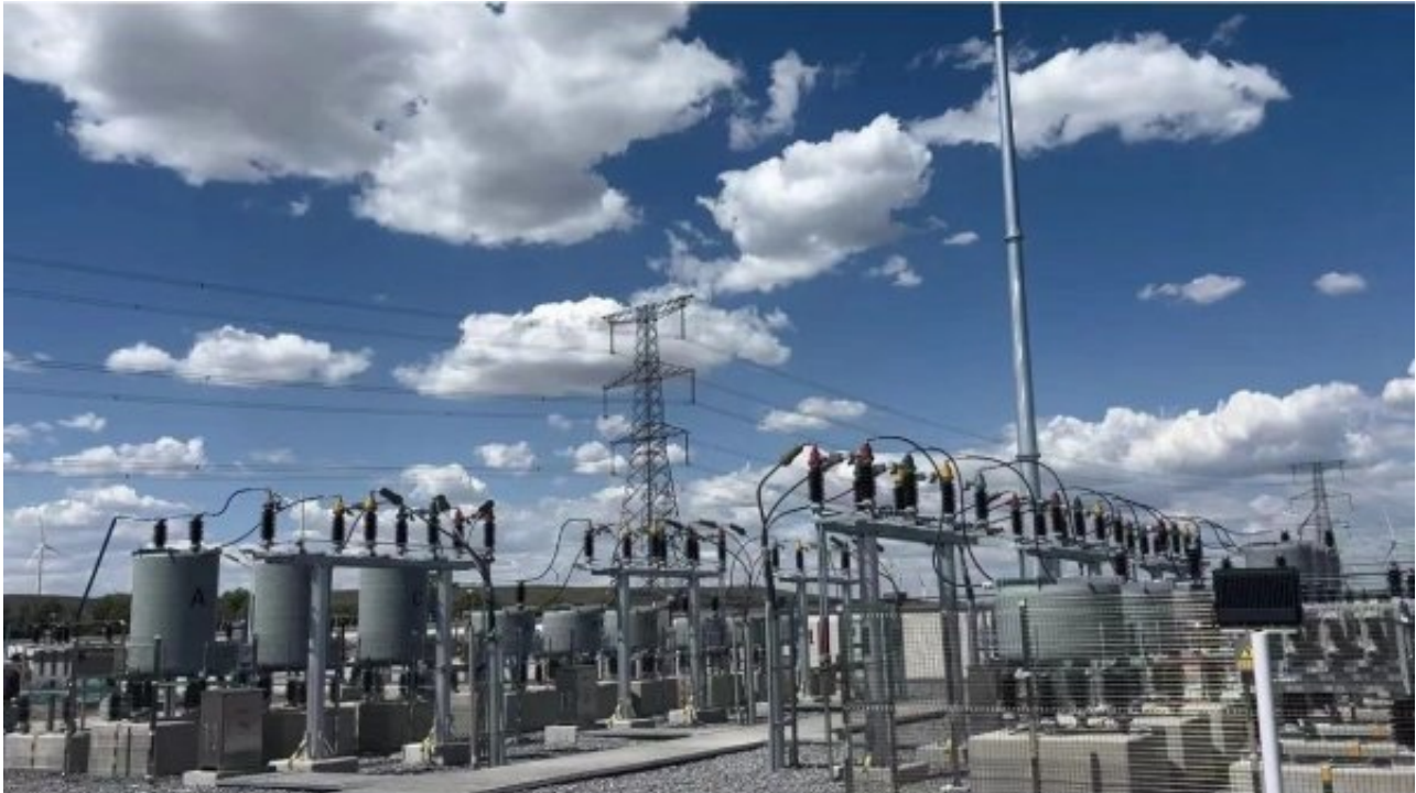
张北大西湾100MW光伏发电平价上网试点项目位于河北省张家口市张北县满德堂村东北侧，规划光伏装机容量为100MW，本工程共设35个光伏发电单元，一次建成全容量投运。
