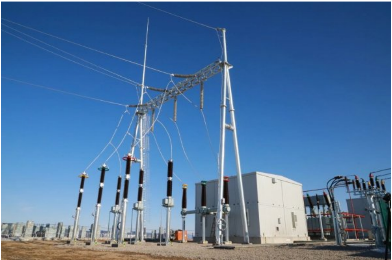
该项目在东昂淖海营光伏电站现有设施的基础上，新增了34个2.88MW和1个1.28MW的光伏发电单元，总容量100MW。电力通过地下和架空35kV线路输送至220kV升压站。经过淖那线、旭晟站、恒丰站，最终到达中都换流站并网。为了支持这一扩展，新建了一条全长12.04公里送出线路已经全部建设完成，并且在2023年12月29日通过了质量监督验收、生产验收合格。
